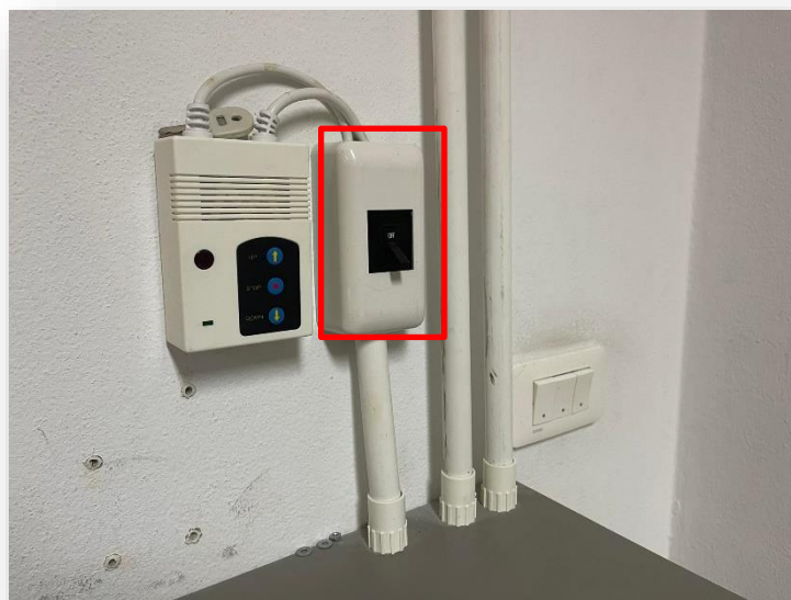
ภาพ 6 เปิดเบรกเกอร์ควบคุมไฟและเครื่องเสียง
