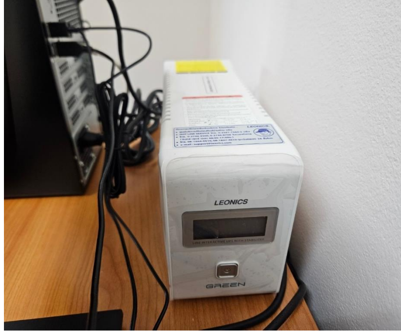
ภาพ 13 เครื่องสำรองไฟ (UPS) ขนาด 850VA รุ่น Green-800V ยี่ห้อ Leonics
