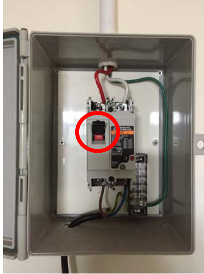
ภาพ 44 ลักษณะของเบรกเกอร์ “ON”
