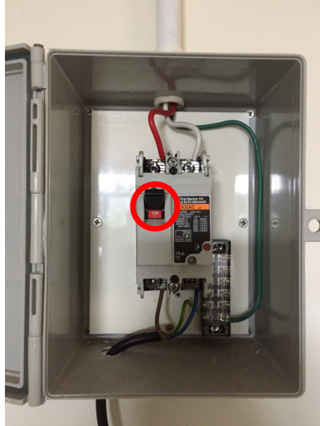
ภาพ 74 การเปิดเบรกเกอร์ไปที่ “ON”
