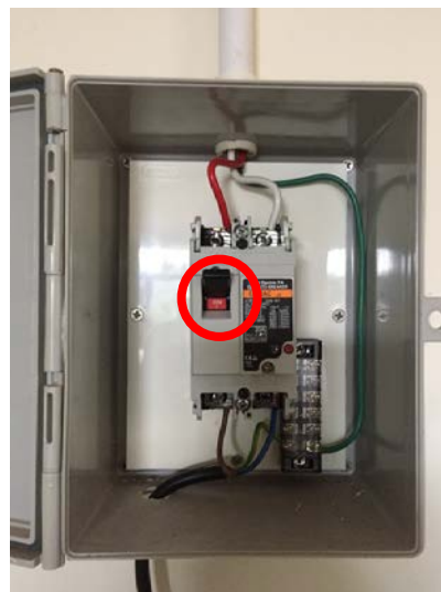
ภาพ 88 การเปิดเบรกเกอร์ไปที่ “ON”
