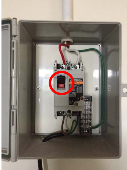
ภาพ 66 การเปิดเบรกเกอร์ไปที่ “ON”
